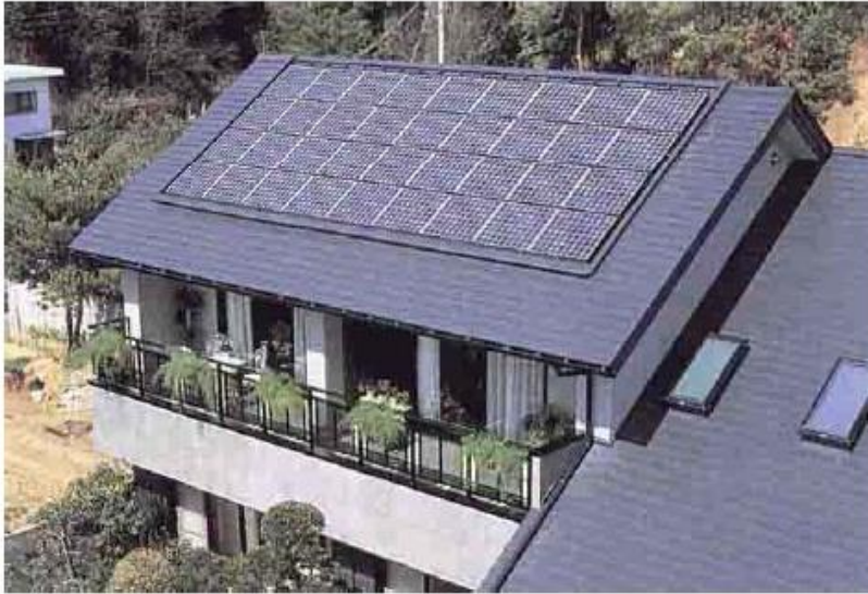
Moduli fotovoltaici integrati nella copertura a falda inclinata
